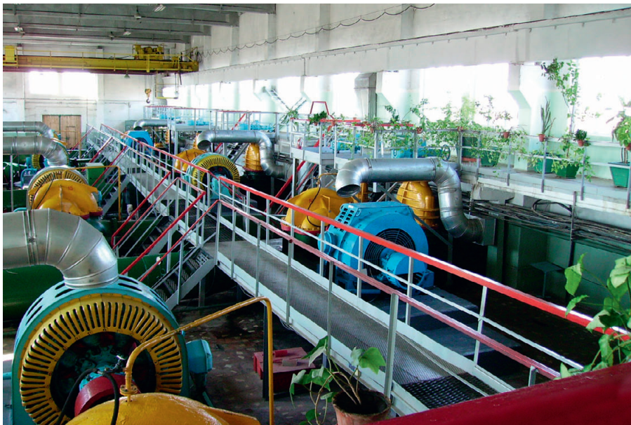
Рис. 2. Машинный зал насосной станции НС-5
