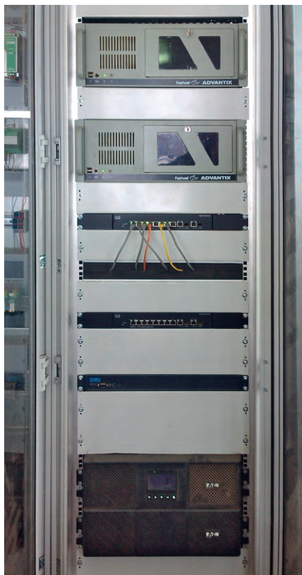
Рис. 16. Внешний вид шкафа управления системы УПСВ
