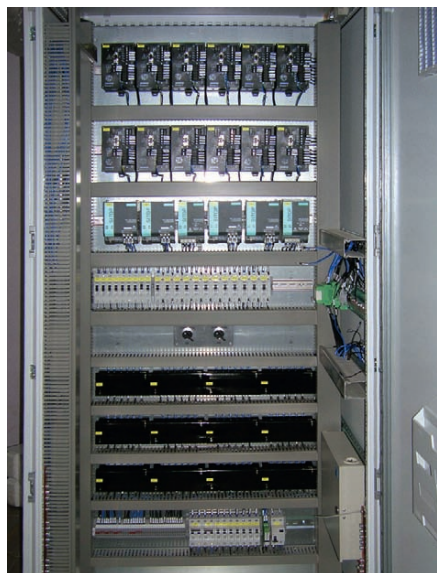
Рис. 3. Шкаф телеизмерений (вид спереди)
