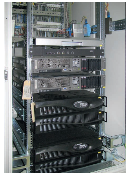
Рис. 7. Общий вид шкафа серверов СТМ
