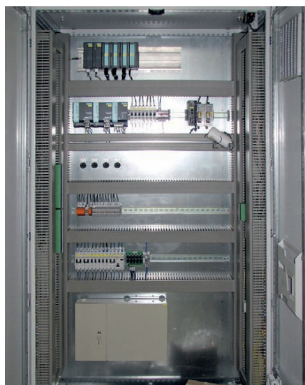
Рис. 4. Шкаф приёма телесигналов (вид спереди)
