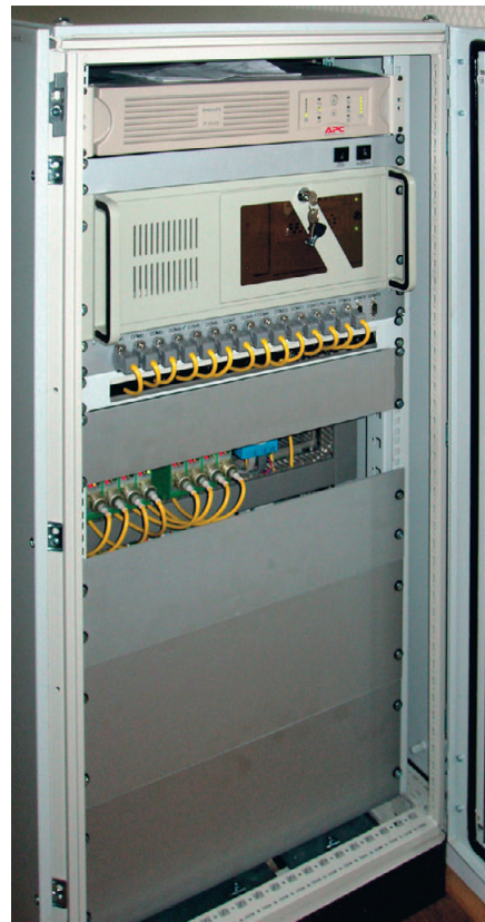
Рис. 4. Серверный шкаф ДПУ
