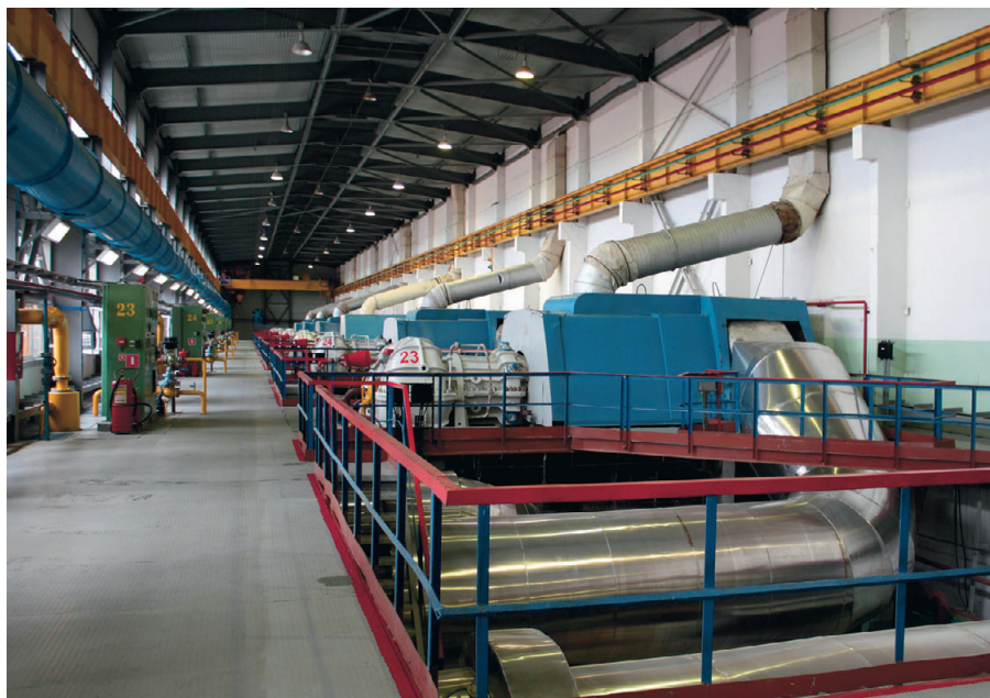
Газоперекачивающие агрегаты ГТК-10-4 на компрессорной станции в Тюменской области
