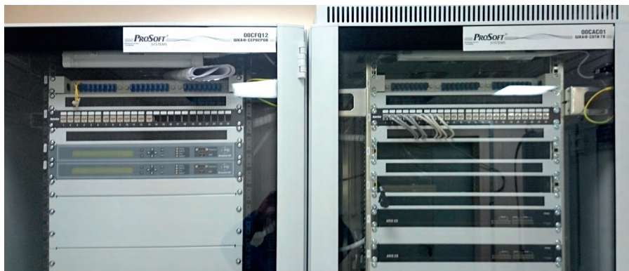
Рис. 5. Основное оборудование СОТИ АССО, шкаф серверов
