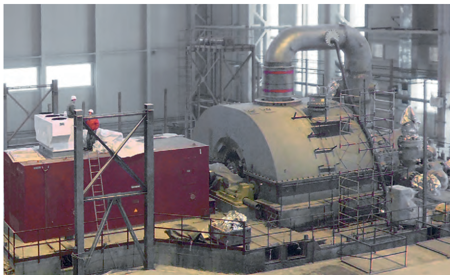
Рис. 1. Парогазовая установка ПГУ-410Т
