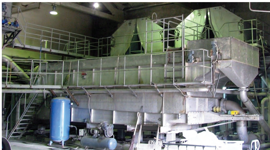
Рис. 1. Флотационная установка МСН 60
