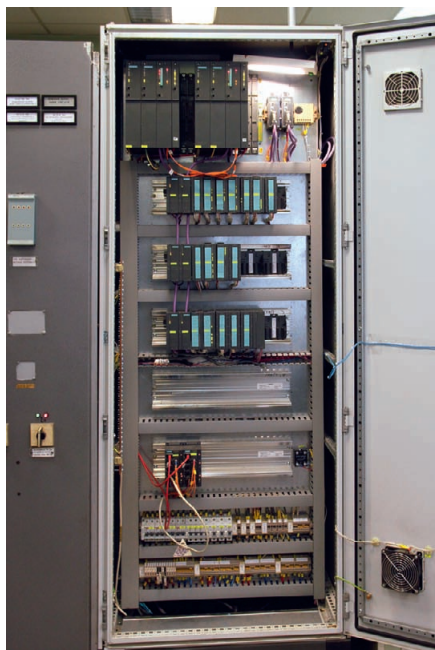
Рис. 3. Шкаф управления № 2 ТФУ
