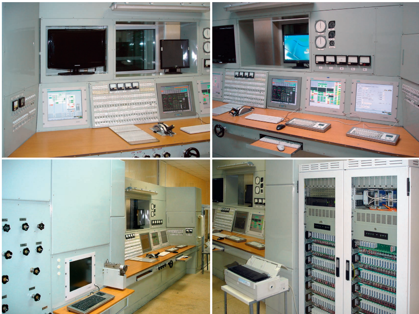
Внешний вид кабины наблюдения испытательного стенда
