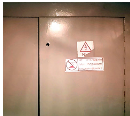
Рис. 2. Шкаф с терморегулятором и выключателем отопления пассажирского вагона ЭПЗД типов ЭД4М, ЭП2Д, ЭТ2А(М), ЭР2Т, ЭТ2, ЭД2Т, ЭП2Д и аналогичных
