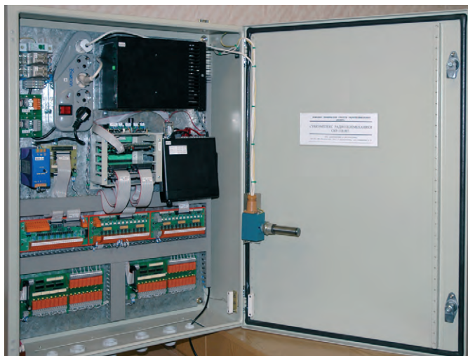
Рис. 5. Шкаф с оборудованием субкомплекса телемеханики СК-ТМ
