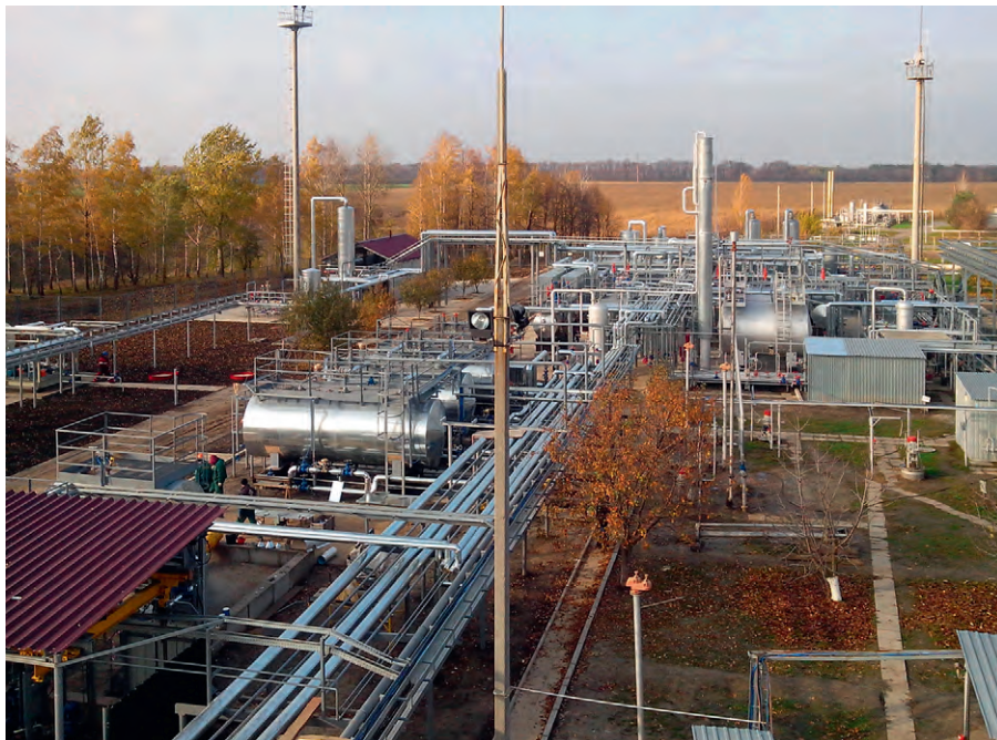
Рис. 2. Установка комплексной подготовки газа
