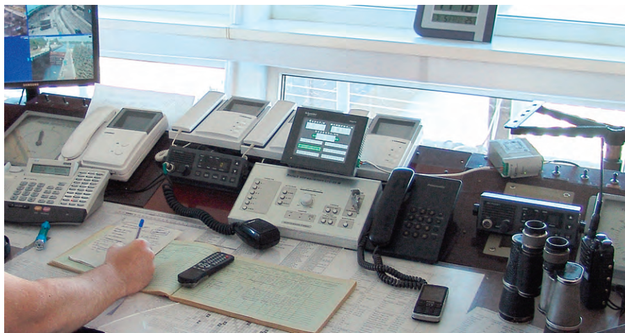
Рис. 8. Панель оператора в ЦПУ шлюза
