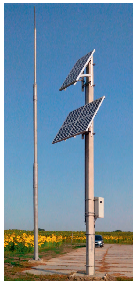
Рис. 5. Внешний вид оборудования автоматизации скважины
