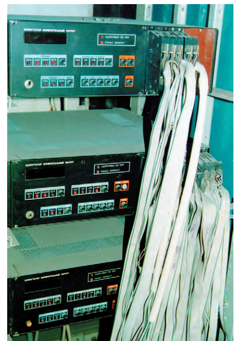
Рис. 4. Шкаф аналоговых коммутаторов Ф2111
