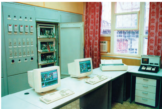
Рис. 2. Помещение операторов АСУ ТП
