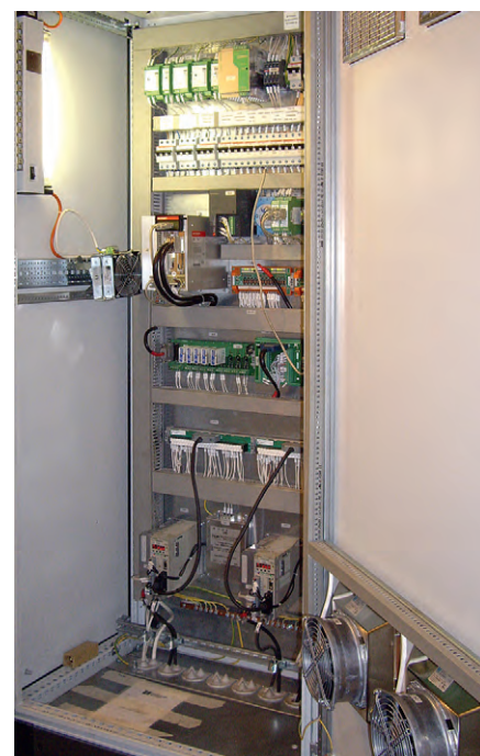
Рис. 6. Щит системы управления
