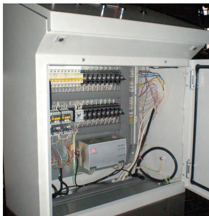
Рис. 4. Электрооборудование системы, установленное на монтажной панели пульта
