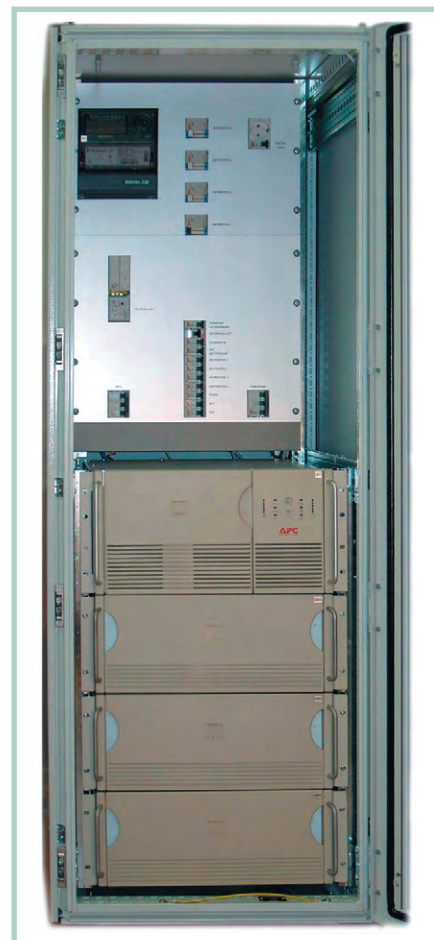
Рис. 3. Щит распределительный САУ ГРС
