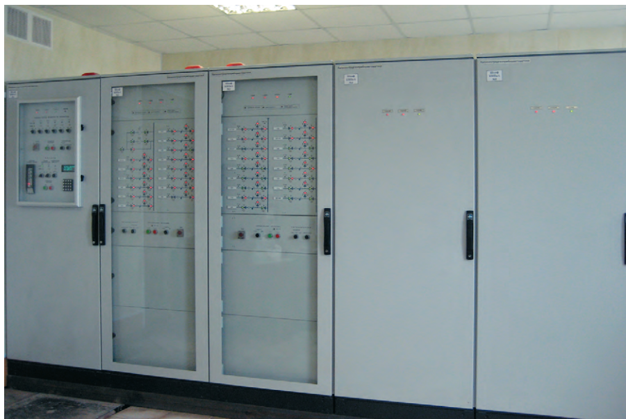
Рис. 4. Шкафы с аппаратурой САУ ГСП
