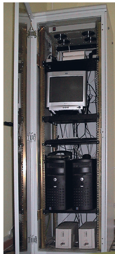
Рис. 6. Серверная стойка центрального диспетчерского пункта
