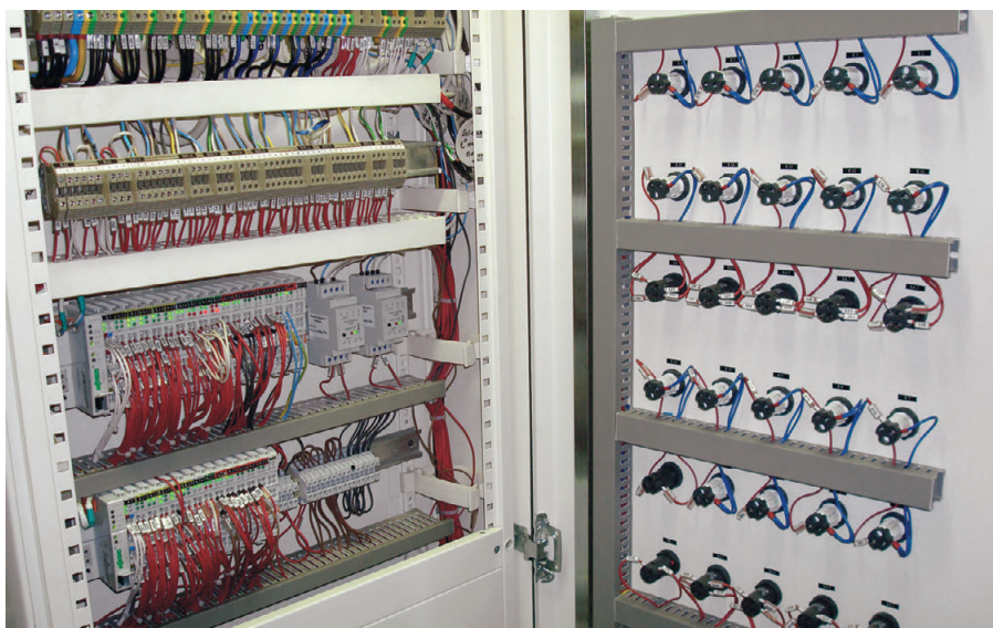
Рис. 7. Внешний вид шкафа локальной автоматики системы вентиляции
