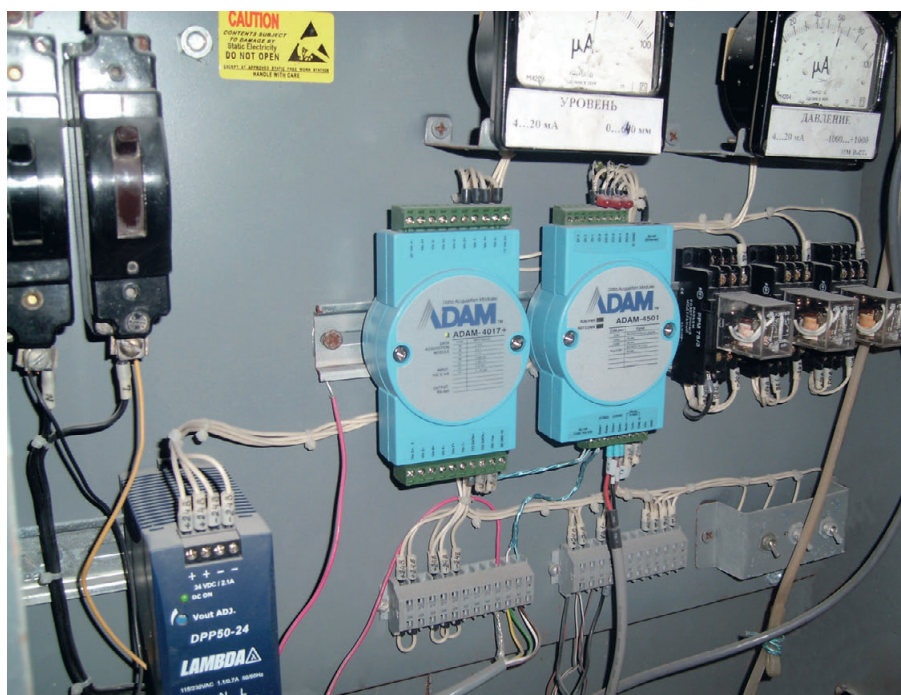
Рис. 7. Внешний вид приборов шкафа КИП
