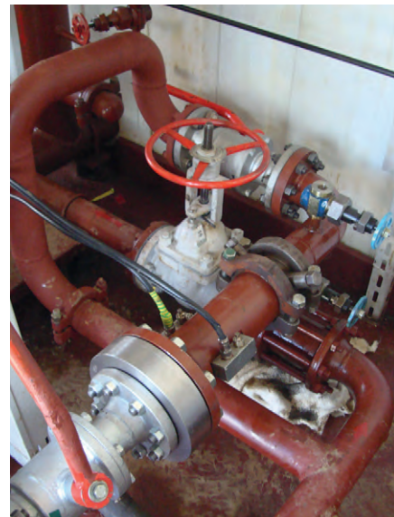
Рис. 7. Установка зондирующего блока влагомера «Сател-РВВЛ» в сливном трубопроводе из измерительной ёмкости АГЗУ «Мера»
