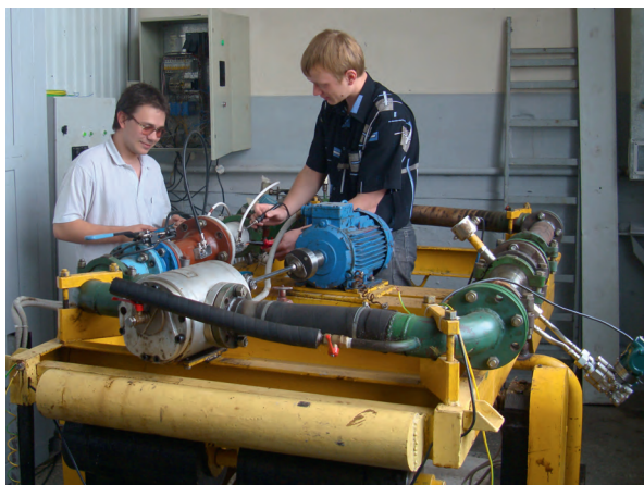
Рис. 12. Общий вид испытательной установки «Сател-УИВ» в процессе монтажа на ней зондирующего блока влагомера «Сател-РВВЛ»
