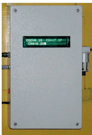
Рис. 3. Электронное табло на панели шкафа управления
