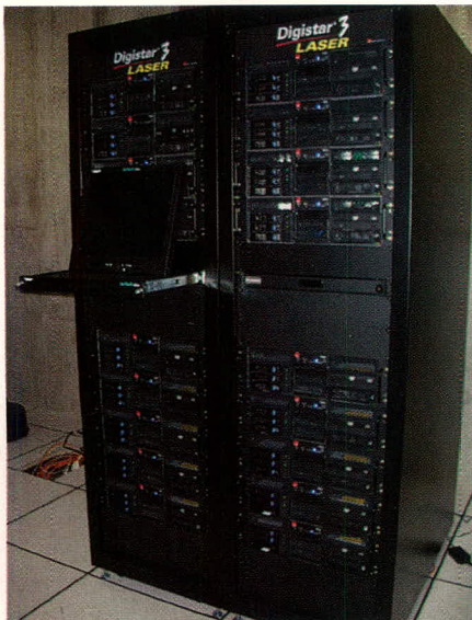
Рис. 7. Стойка с 16 процессорными блоками для управления проектором
