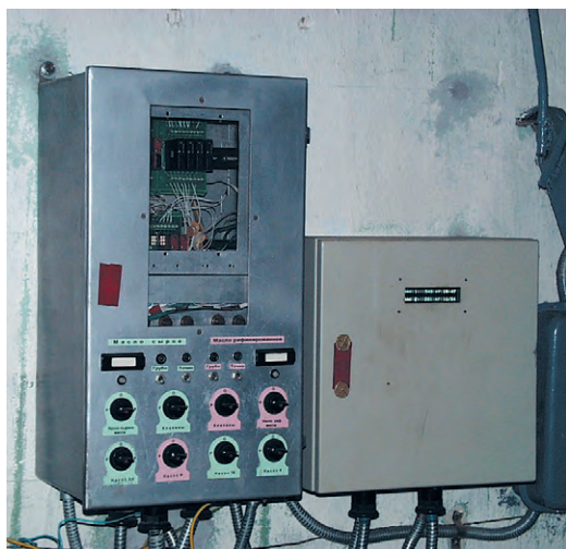
Рис. 3а. Локальная станция в цехе
