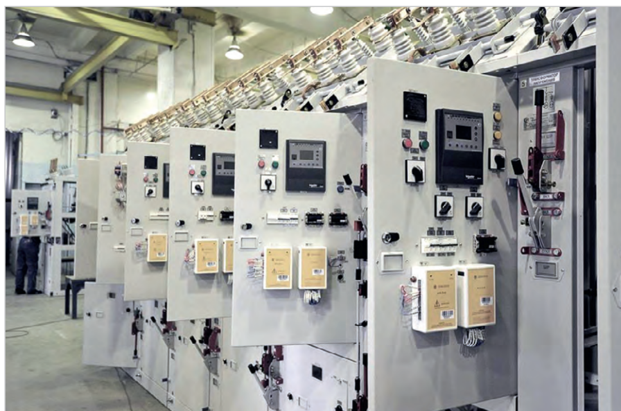
Рис. 1. Шкафы электропитания электроустановки
