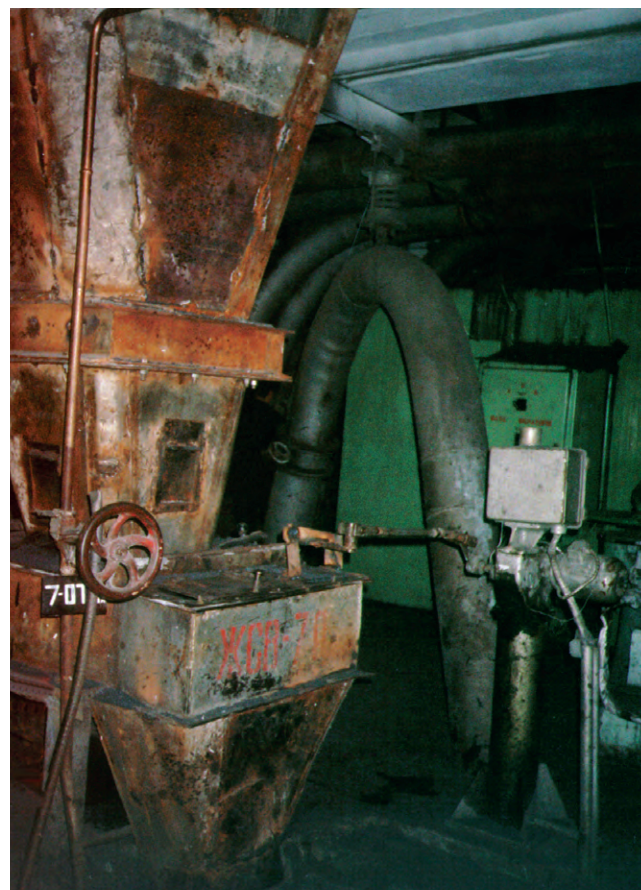
Рис. 6. Питатель сырого угля тепловой электрической станции
