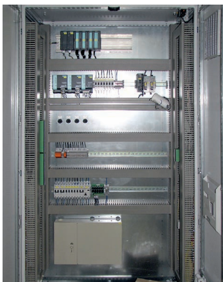
Рис. 4. Шкаф приёма телесигналов (вид спереди)
