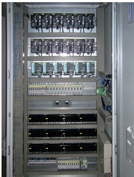
Рис. 3. Шкаф телеизмерений (вид спереди)
