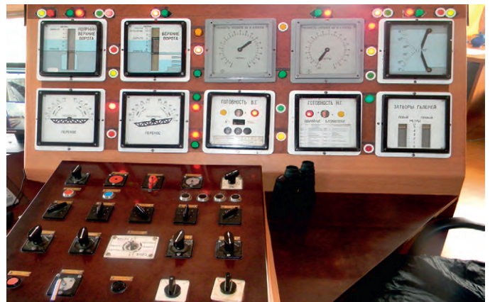
Рис. 7. Штатный пульт управления шлюзом в башне ЦПУ
