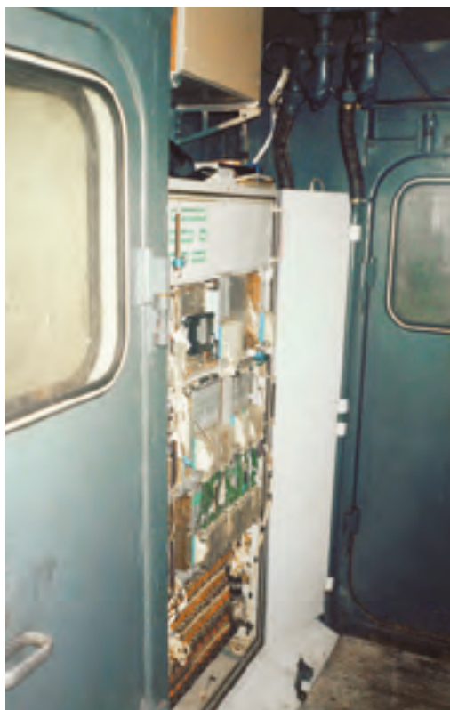
ЦБУ АПК «Пилот» в процессе эксплуатационных испытаний
