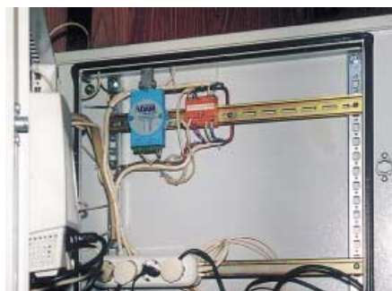
Рис. 6. На задней секции монтажного шкафа ИСР размещён преобразователь RS-232/RS-422
