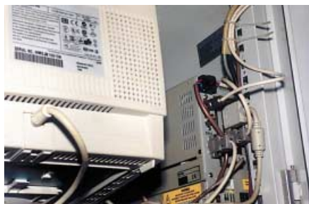
Рис. 5. Вид монтажного шкафа ИСР сзади (справа — промышленный компьютер)
