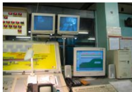
Рис. 4. Вид пульта оператора и станции WinCC
