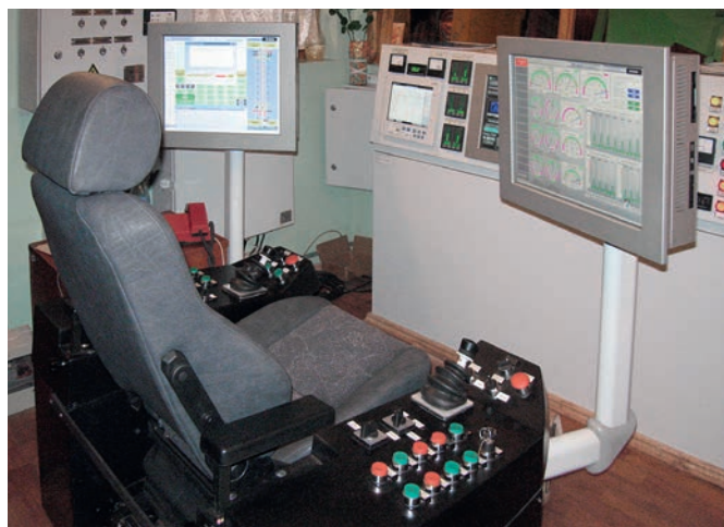
Рис. 5. Кресло-пульт управления шахтной подъёмной машиной ПУШПМ
