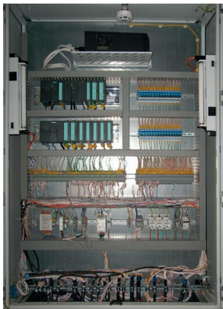
Рис. 3. Шкаф контроллера КПУ основной системы управления ЗКДР.2
