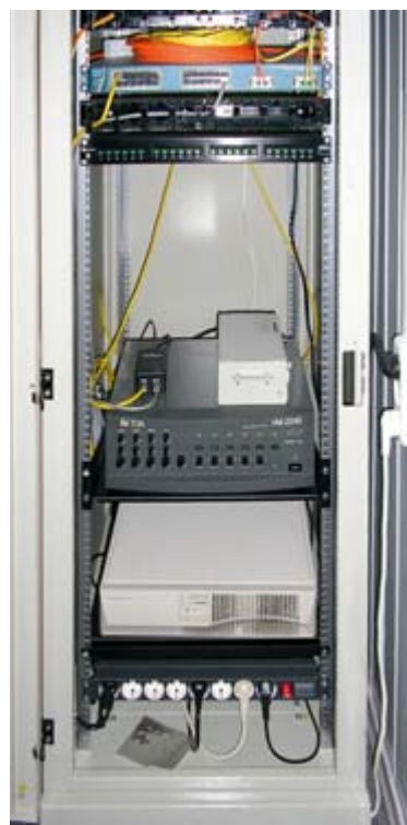
Рис. 5. Устройства системы РИДОП в станционной консоли
