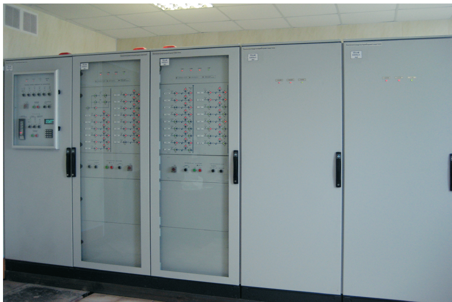
Рис. 4. Шкафы с аппаратурой САУ ГСП
