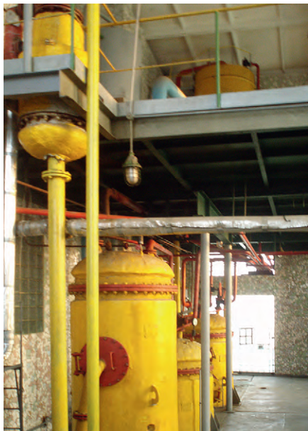
Козловский спиртовой завод: технологическое оборудование участка высокотемпературной варки
