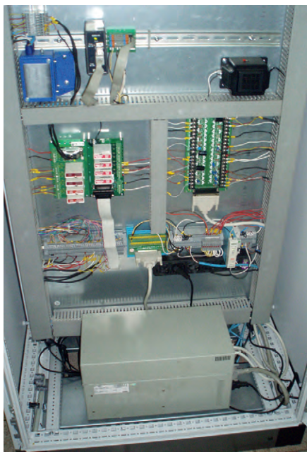
Рис. 1. Оборудование щита управления варочного отделения
