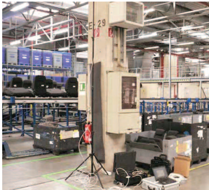
Рис. 9. Мобильное испытательное оборудование для определения качества покрытия беспроводной Wi-Fi-сети
