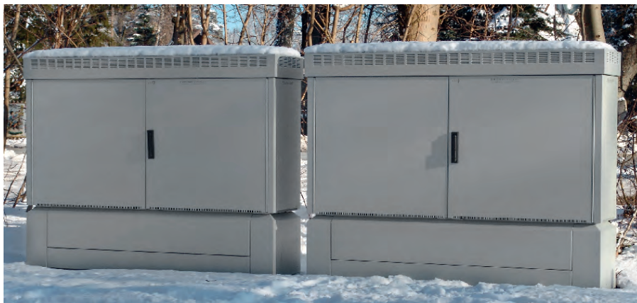
Рис. 5. Шкафы с телекоммуникационным оборудованием
