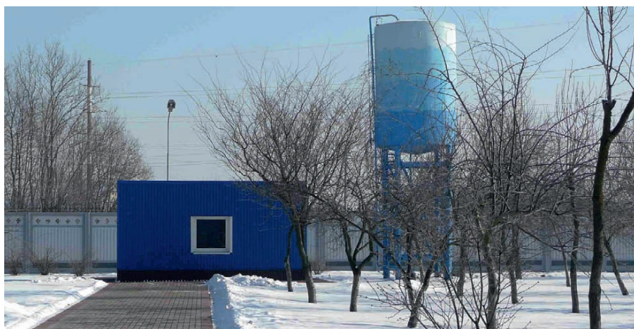
Рис. 3. Скважина (ВНС первого подъёма)
