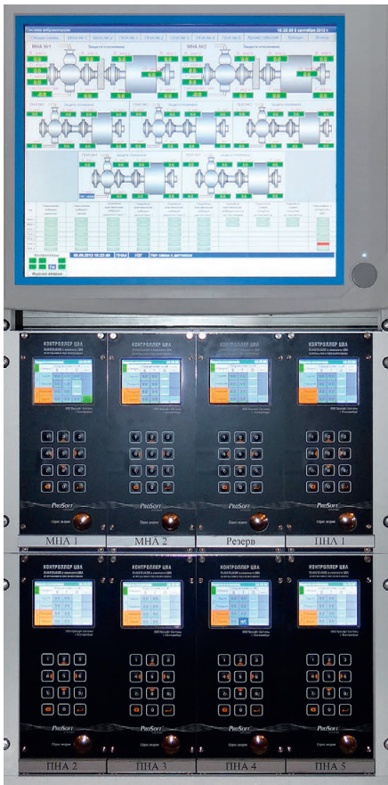
Рис. 7. Шкаф системы контроля вибрации на основе аппаратуры «ЦВА» с АРМ оператора
