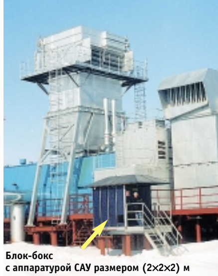
Газоперекачивающий агрегат ГПА-Ц-16 мощностью 16 МВт
