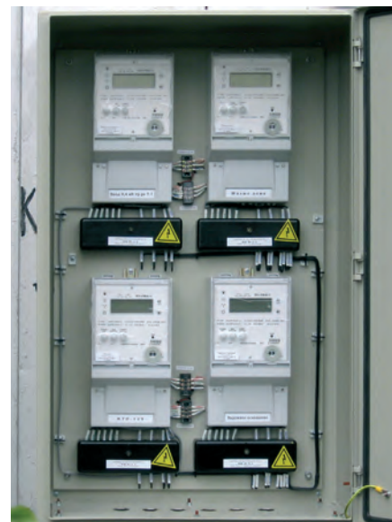
Рис. 3. Вариант установки счётчиков электрической энергии на энергообъекте
