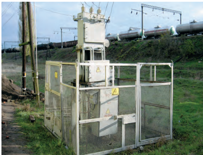
Рис. 1. Комплексная трансформаторная подстанция — энергообъект АСКУЭ ЖУ
