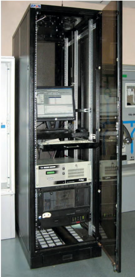
Рис. 7. Стойка с оборудованием центра сбора и обработки данных
