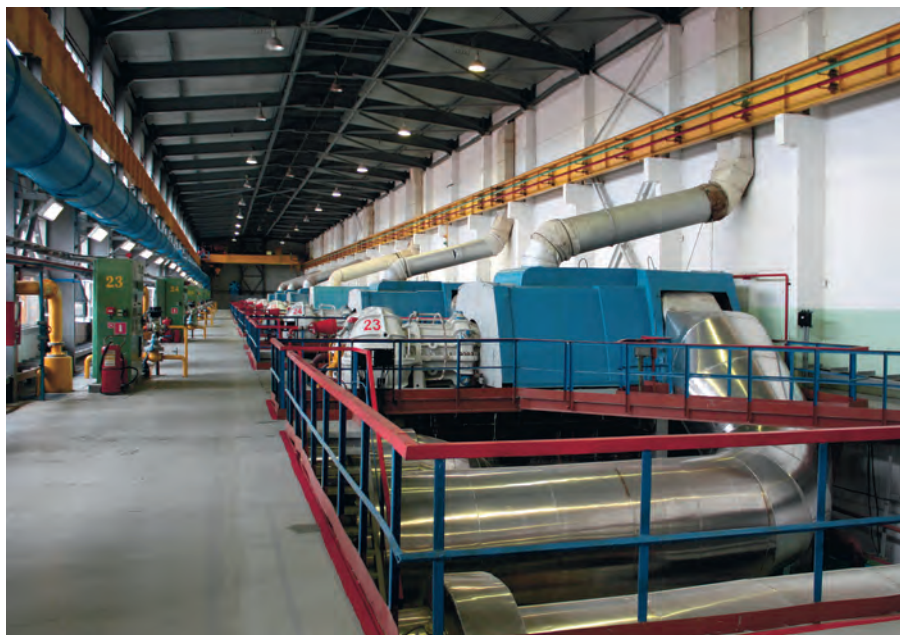
Газоперекачивающие агрегаты ГПК-10-4 на компрессорной станции в Тюменской области
