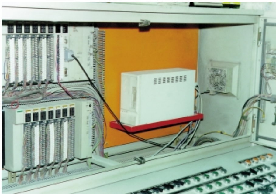
Рис. 4. Пульт управления с открытыми дверцами. На переднем плане контроллер SYSMAC C500 в составе двух крейтов, на заднем – промышленный компьютер PCXU-205
