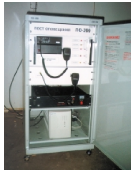
Рис. 2. Системный блок поста оповещения с открытой дверцей
