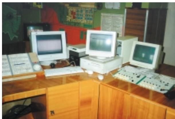
Рис. 7. Центральный пульт оповещения
