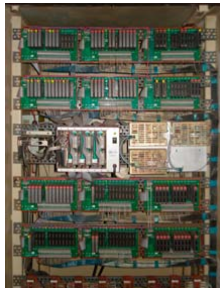
Рис. 6. Размещение контроллера в шкафу фирмы Rittal
