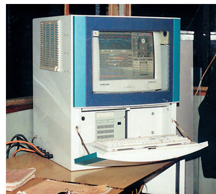
Рис. 7. Рабочая станция дежурных по машинному залу
