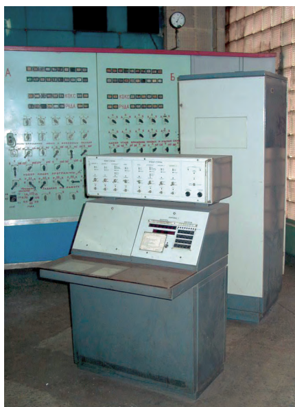
Рис. 4. Пульт управления системой, внедренной на доменной печи № 2 ОАО «Испат-Кармет»
