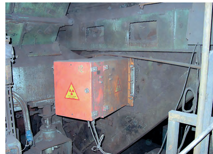
Рис. 2. Установка датчика в весовой воронке доменной печи
