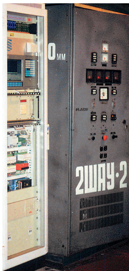
Рис. 5. Шкаф управляющей ЭВМ
