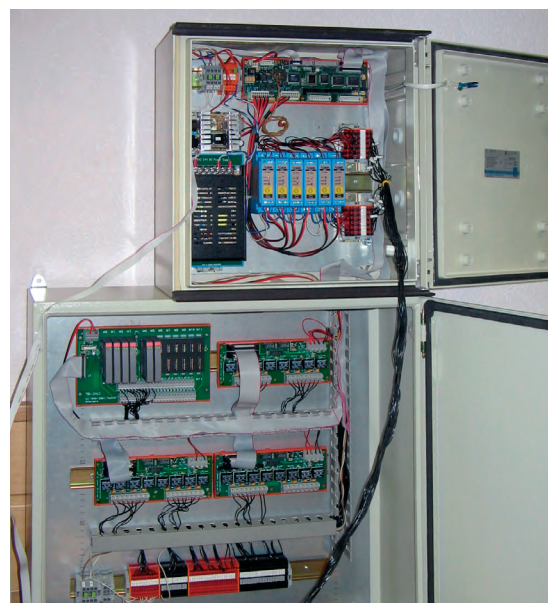
Рис. 2. Блок контроллера БСУ
