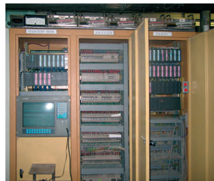
Рис. 5. Шкафы контроллеров «Обжиг» и «Транспорт печи»
