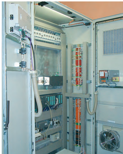
Рис. 7. Общий вид шкафа управления стендом сушки
