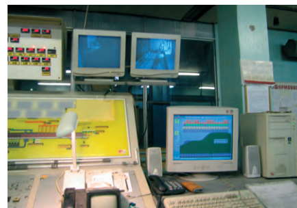
Рис. 4. Вид пульта оператора и станции WinCC
