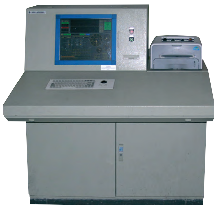
Рис. 2. Рабочая станция дежурного электрика обжимного цеха
