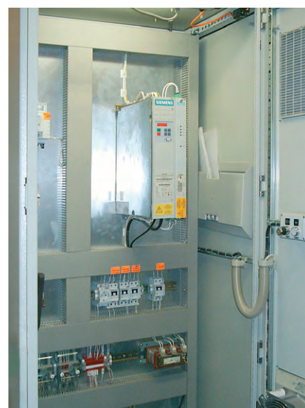
Рис. 5. Общий вид шкафа управления приводом крышки
