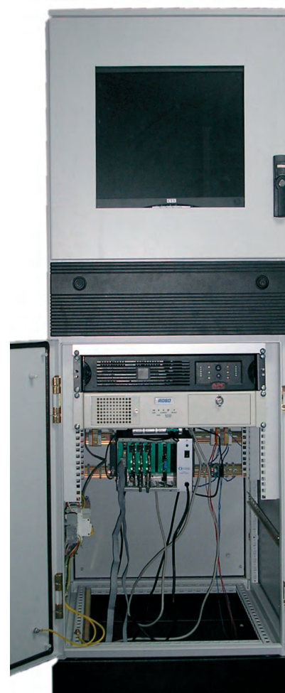
Рис. 3. Размещение устройств в индикаторном шкафу
