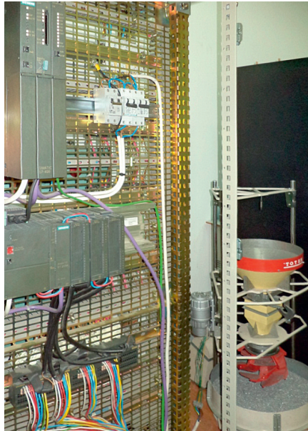
Рис. 8. Шкаф полигона (справа модель РЗУ) для отладки КТС и ППО АСУ «Ротор» на оборудовании SIMATIC S7
