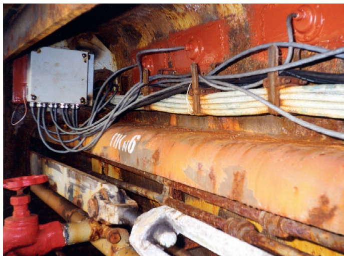
Рис. 1. Удалённый измерительный модуль и датчики системы СПР-3М, установленные на комингсе теплохода «Путеж»
