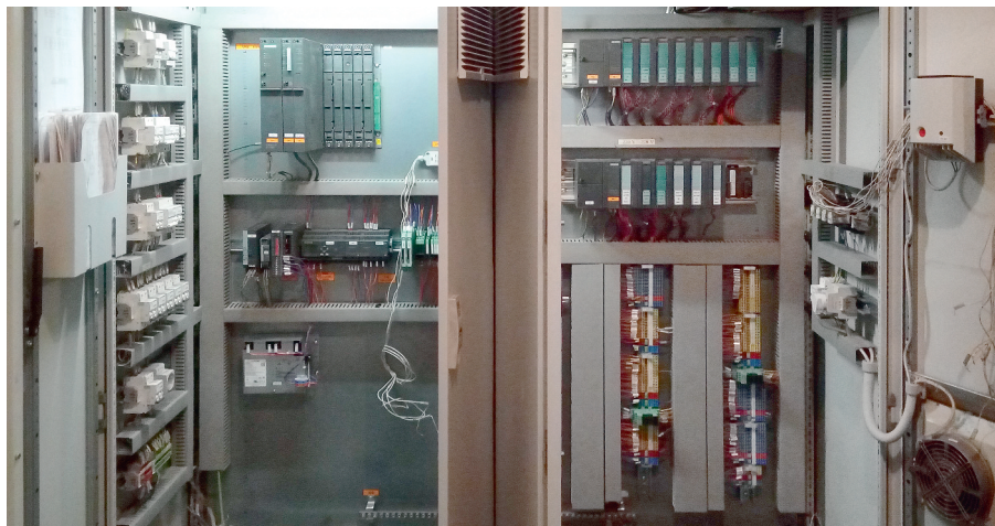
Рис. 4. Шкаф с основным контроллером и контроллером защиты
