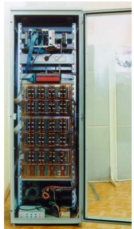
Стойка для подключения к станционным устройствам автоматики
