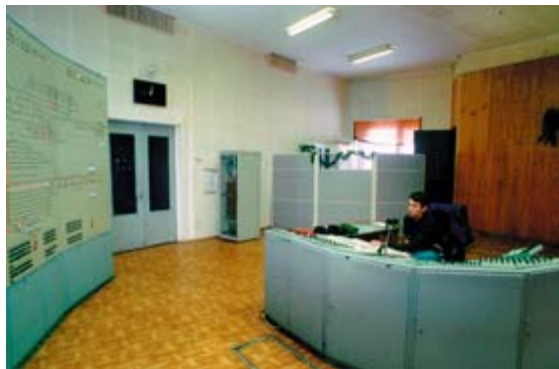
Размещение аппаратуры в помещении дежурного по станции
