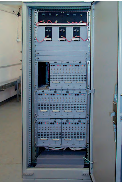
Рис. 8. Стойка СТФ аппаратуры ФМ-канала
