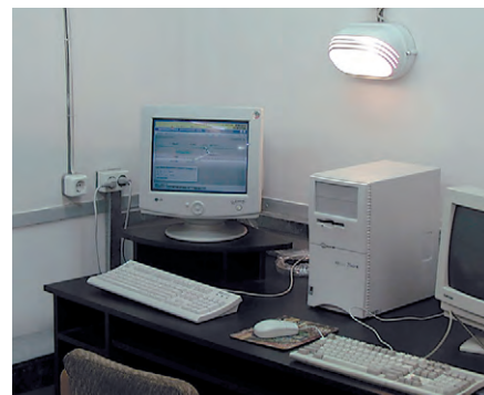
Рис. 9. Резервный АРМ ДСЦТ в помещении АТДП
