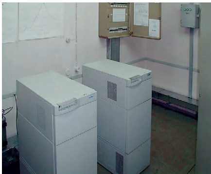
Рис. 10. Фрагмент оборудования системы электропитания СА с ИБП
