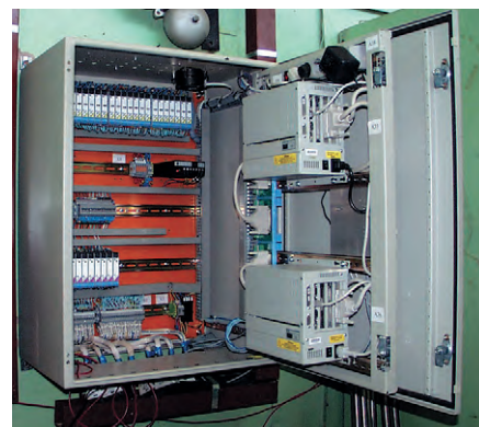
Рис. 3. Технологическая станция, обслуживающая 20 резервуаров парка
