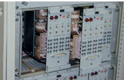
Рис. 7. Блоки БФ в стойке аппаратуры ФМ-канала
