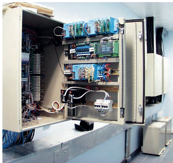
Рис. 7. Один из шкафов АСУ ТП ПСТ-2
