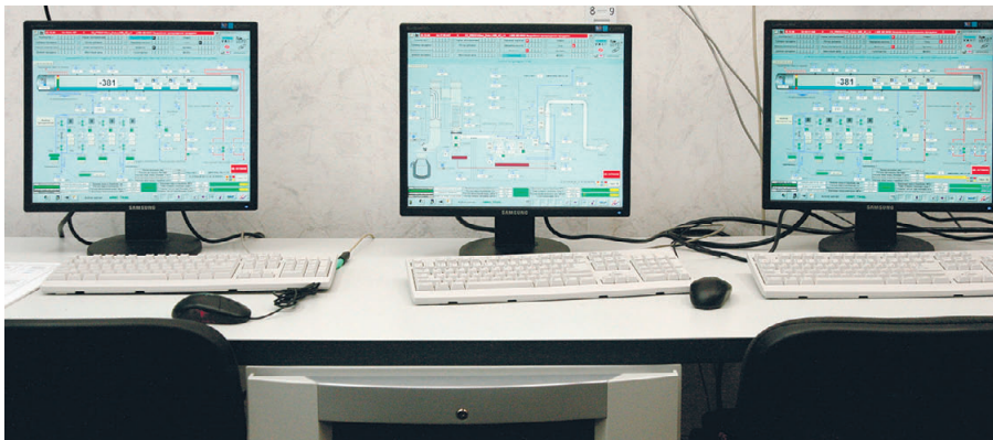
Рис. 2. Мониторы автоматизированных рабочих мест АСУ ТП ГОТ конвертера
