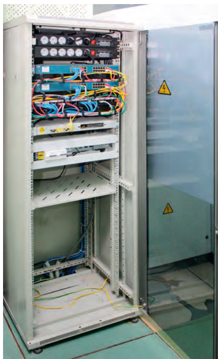
Рис. 3. Шкаф комплекса технических средств связи службы Э
