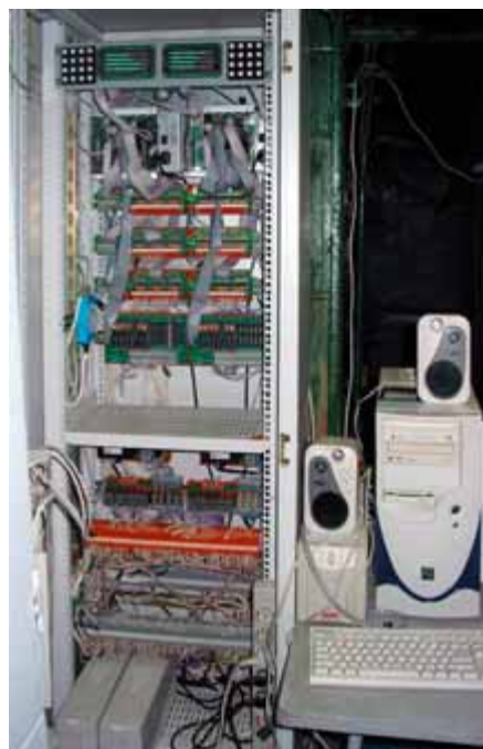
Рис. 2. Общий вид аппарата АКХЗ, смонтированного в шкафу PROLINE Service PLUS+
