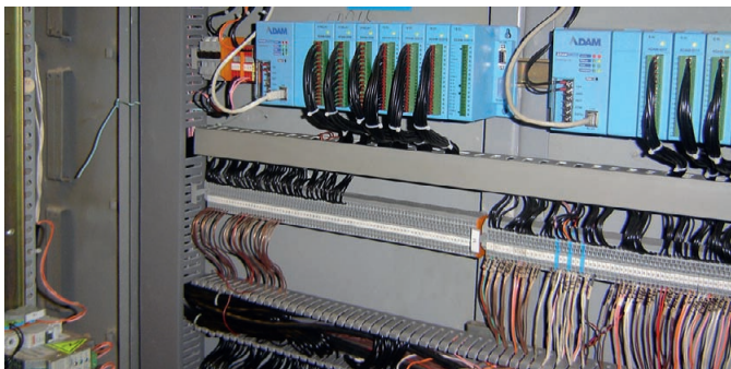
Рис. 4. Часть основного шкафа автоматики, укомплектованная контроллерами ADAM-5000/EKW, отвечающими за реализацию централизованного управления
