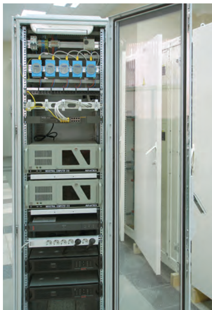
Рис. 4. Общий вид шкафа системы автоматизации вентиляторной градирни
